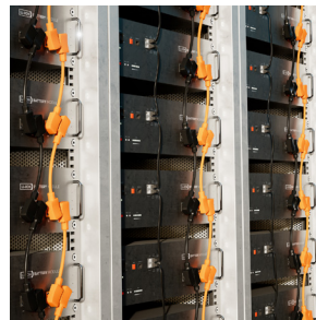
蓄電システム
