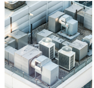
エアハンドリングユニット
